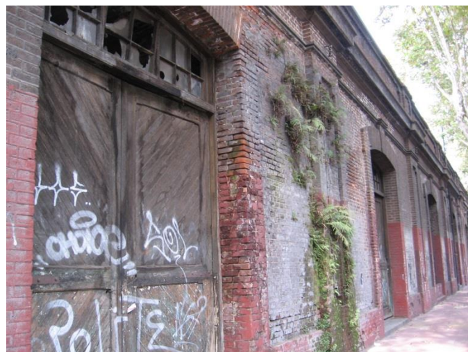
2007. Bajoviaducto y locales abandonados sobre Av Juan B Justo.
