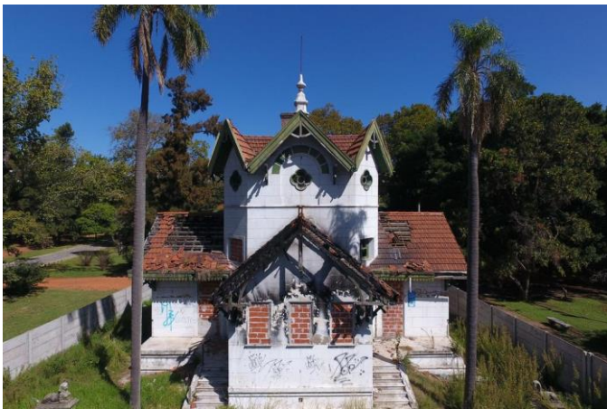
El "Tambito" o "Casa Joven" parcialmente quemado, con la carpintería y estructura de madera de los techos destruida.
