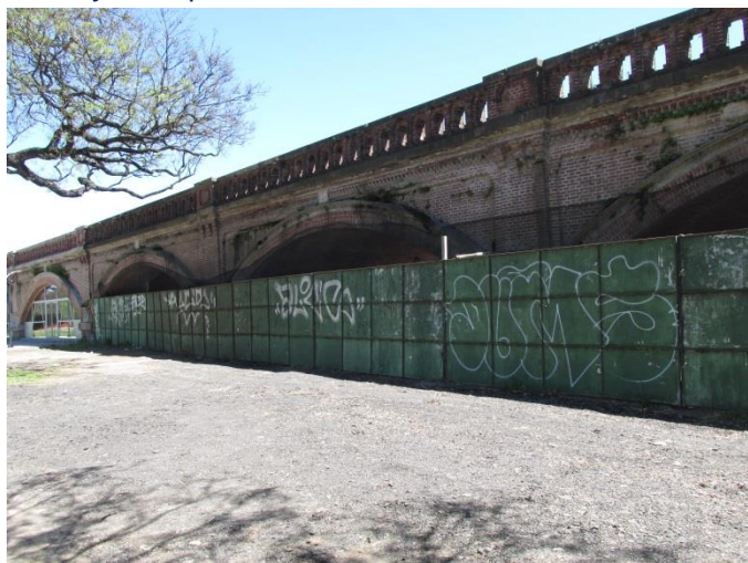
Bajo viaducto de la Línea Mitre ocupado comercialmente en forma ilegal. Sobre Av Casares frente al Planetario.
