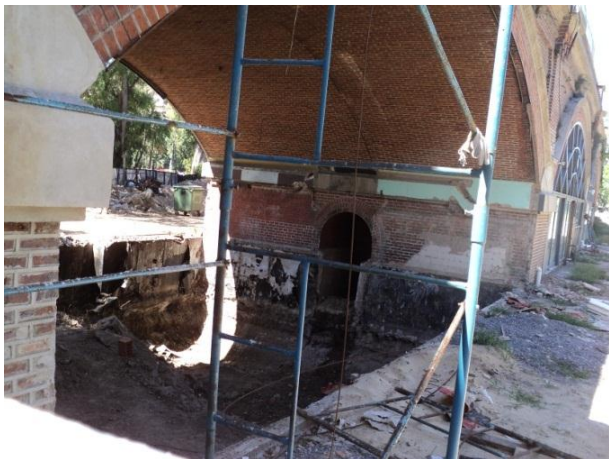
Peligrosas excavaciones ilegales bajo el viaducto ferroviario. Obra sin planos registrados, sin cartel y sin profesional responsable. El Ministerio de Desarrollo Urbano no actúa.
