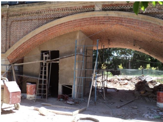
Arco N° 7 del viaducto ferroviario. Debía quedar libre como parte Integrante del Paseo Marcela Brenda Iglesias. Así lo fijan la concesión del espacio y la ley 2366, sin embargo, construyen en él. El Ministerio de Desarrollo Urbano no actúa.
